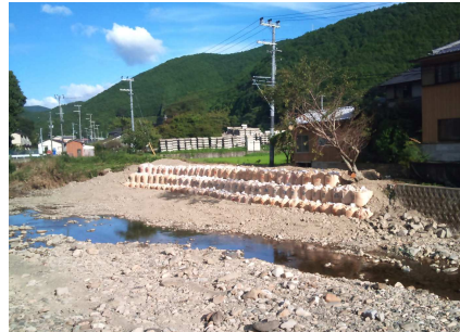
生馬川被災状況 (上富田町生馬地先)
